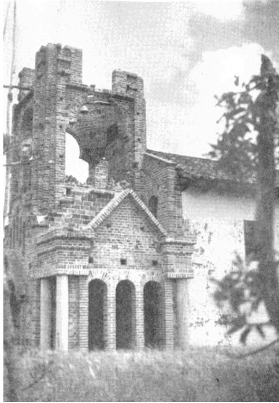
Figura 7. Daños en la torre de la Iglesia de Pandiaco en el Sismo del 14 de Julio de 1947 (Ramírez, 1948).
